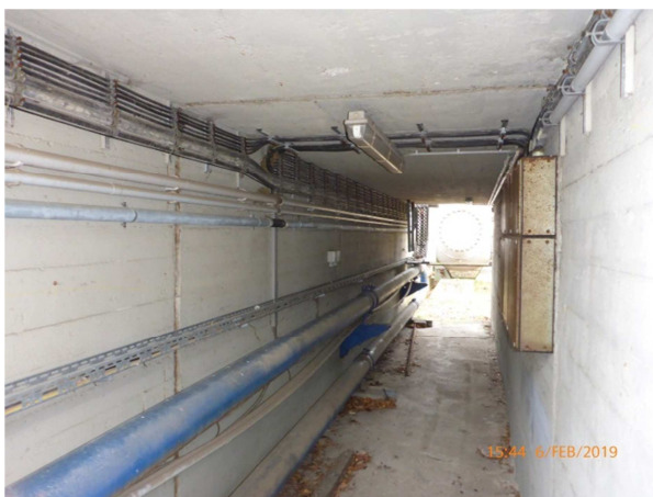
Bild 2: Beispiel einer der beiden Unterführungen der Brücke mit umfangreichen Leitungen, Schaltkästen, Rohren u.a.
